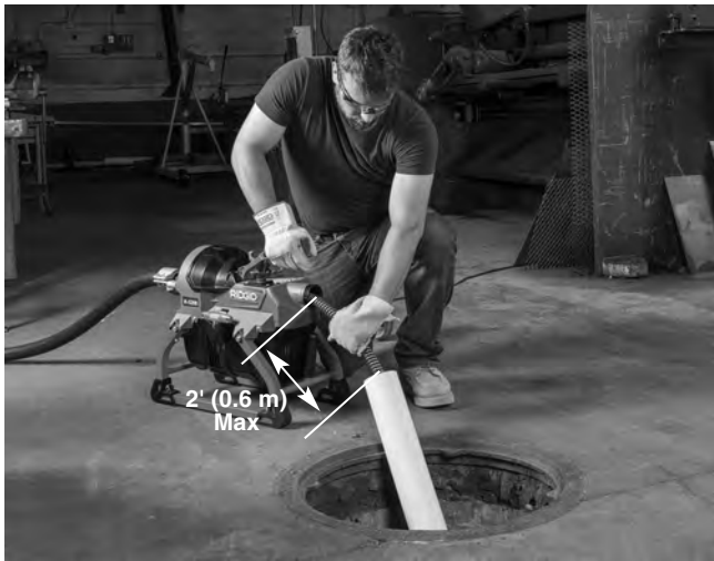
Figure 5 – Prolongation de la conduite d'évacuation pour arriver à moins de 2' (0.6 m) de la sortie de câble de la machine
