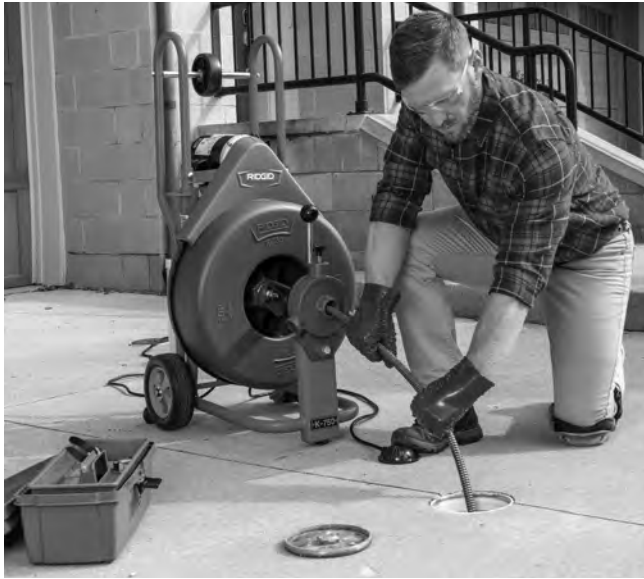
Figura 12 – El operario en posición correcta introduce el cable manualmente en el desagüe
