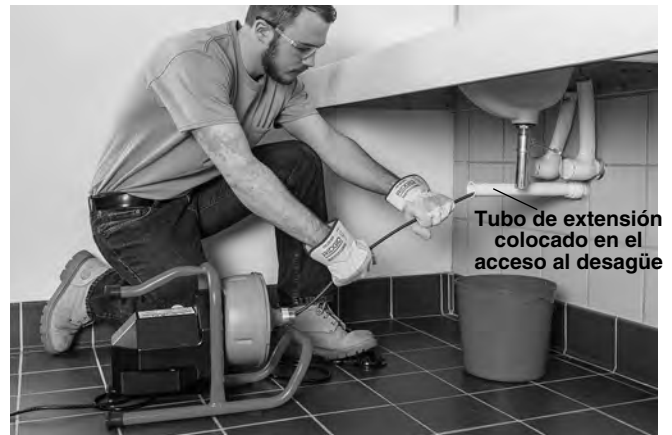
Figura 7 – Manera en que se prolonga el desagüe en 2 pies desde su acceso.
