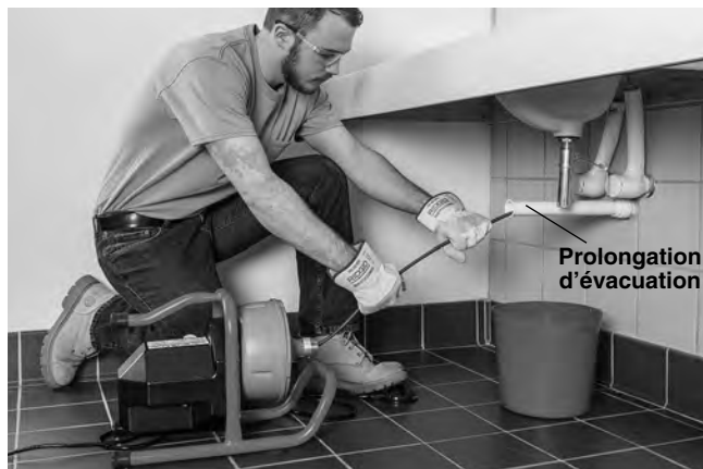
Figure 7 – Exemple de prolongation d'une évacuation pour l'amener à moins de 2 pieds de la sortie du tambour.
