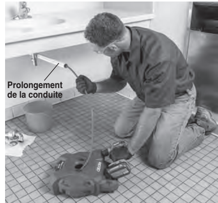
Figure 5 – Exemple d'une prolongation de conduite arrivant à moins de 3 pi du dégorgeoir
